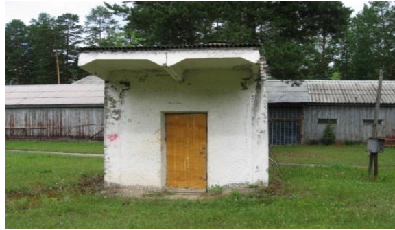
Сооружение: водозаборная скважина № 407
