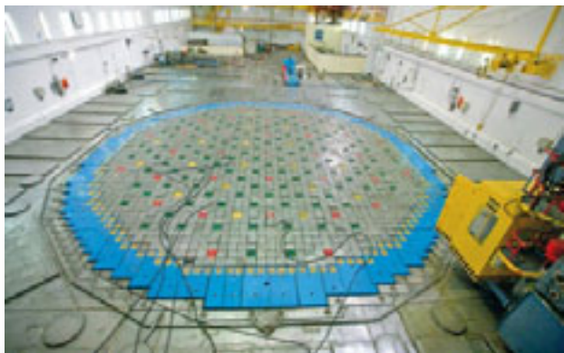
Реакторный зал Ленинградской АЭС с реактором РБМК-1000
